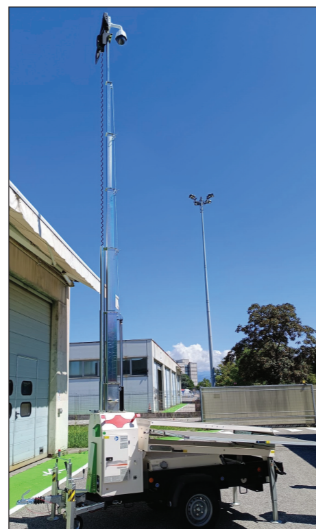
Struttura facilmente trasportabile e messa in servizio semplificato = operatività in pochi minuti per monitorare da remoto lo stato del cantiere e il traffico in tempo reale
